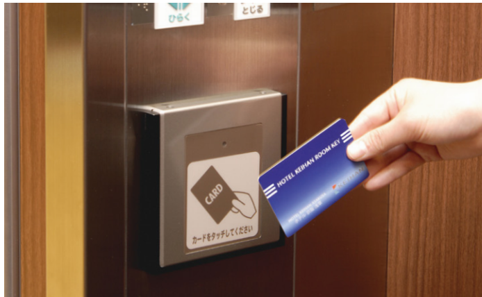
エレベーターセキュリティー Elevator security
